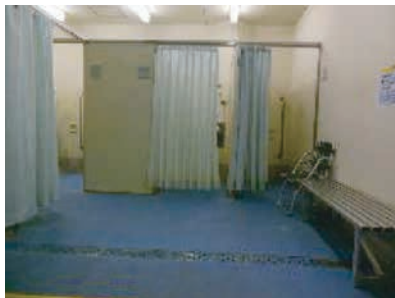
写真3-5-1-4：シャワーブース
