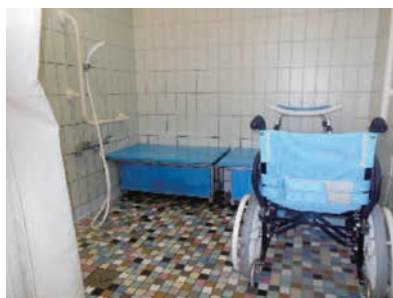
写真3-5-7-3：車いす用シャワー室
